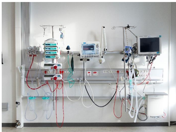
Overvågningsudstyret på en intensivstue
